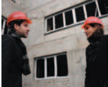
Visite du chantier de l'école française du Caucase par Florence Fournier, directrice, et le chef de chantier
